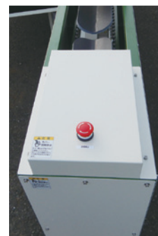
非常停止ボタン
